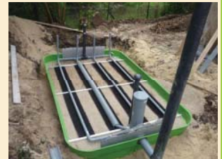
Filière compacte : filtration des eaux prétraitées
