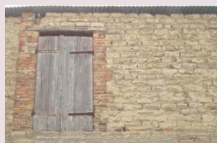
Nombre de maisons étaient en carreaux de terre à Mardeuil. Ici, une façade en carreaux de terre, rue Pasteur. L'ouverture du grenier, au ras du plancher facilitait l'engrangement des récoltes.
