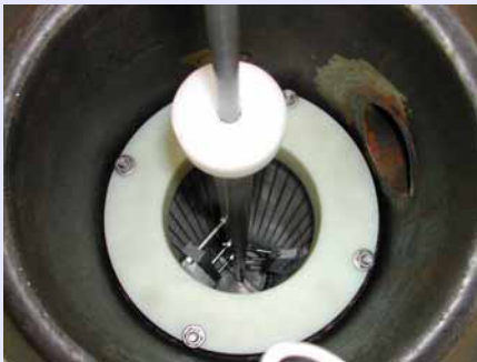
Intérieur du filtre
