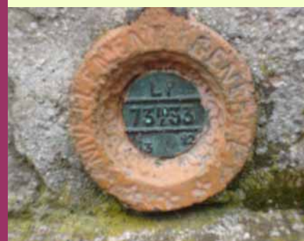
Le mur de l' église de Mardeuil porte un repère altimétrique gravé 73, 33 mètres.
